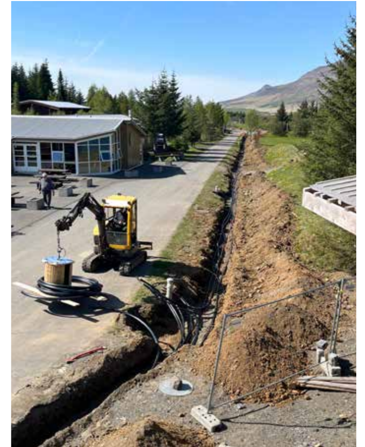
Í tengslum við byggingu nýs matskála, var nýr inntaksskápur settur upp vestan megin við íþróttahúsið og öflugir rafmagnsstrengir lagðir yfir í matskálann.
